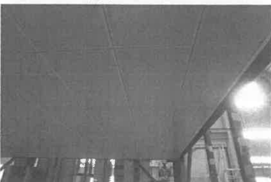
Photo B.15 시험 후 천장재 측면부 & Molding
