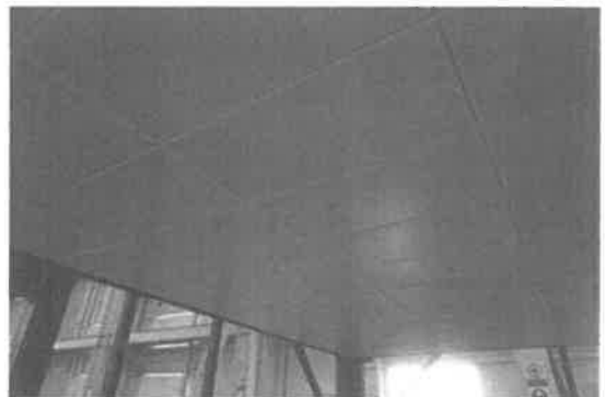
Photo B.14 시험 후 천장재 하부
