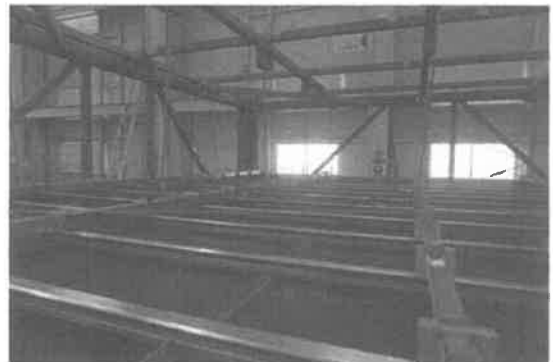
Photo B.12 시험 후 천장재 상부
